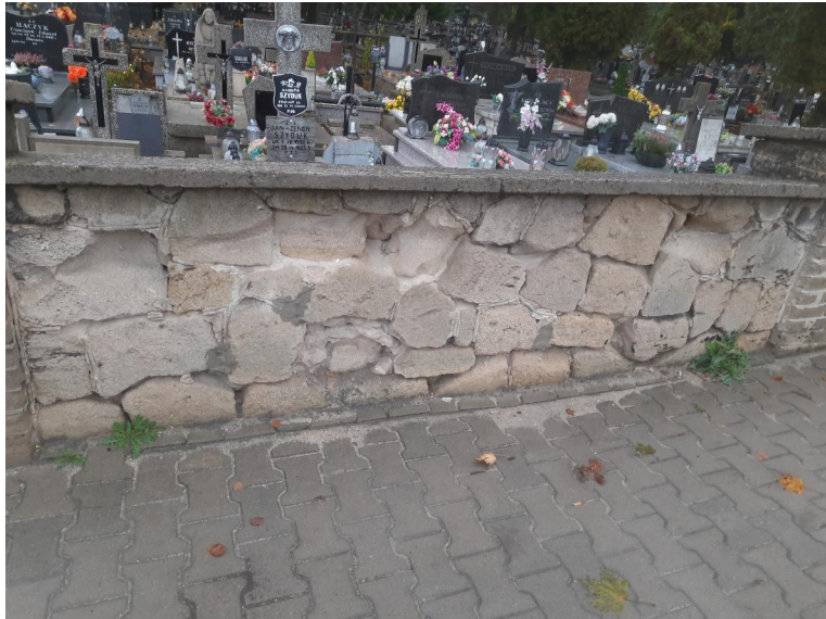
Przęsło ze znacznymi ubytkami w kamieniarkie i spoinach - przeznaczone do uzupełnień oraz konserwacji
