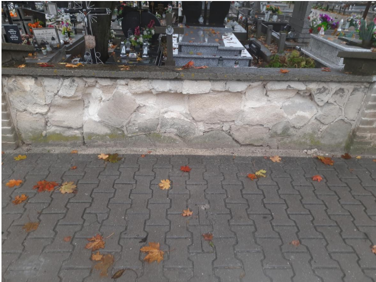
Przęsło z wyraźnymi ubytkami w kamieniarkie i spoinach - przeznaczone do wymiany zniszczonego kamienia, uzupełnień oraz konserwacji
