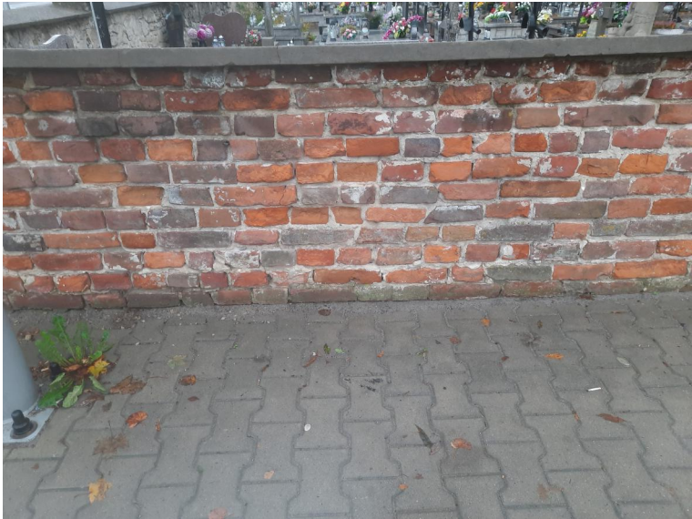
Przęsło w stanie średnim, z ubytkami w ceglach i spoinach - przeznaczone do uzupełnień oraz konserwacji
