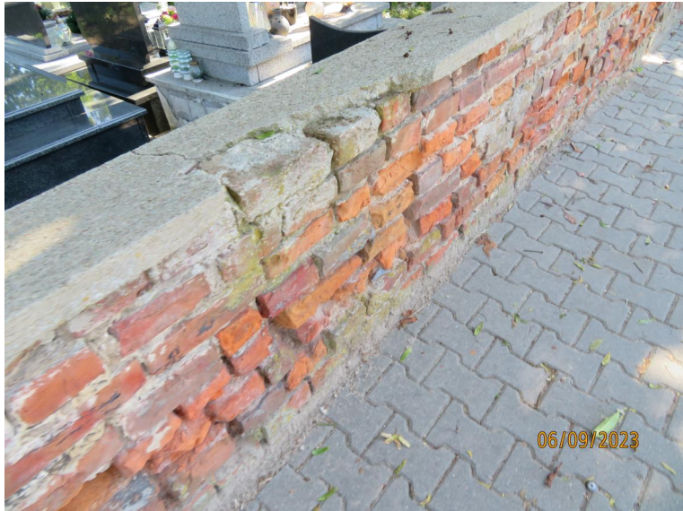
Przęsło ze znacznymi ubytkami w murze i spoinach oraz czapkach betonowych - przeznaczone do napraw, uzupełnień oraz konserwacji
