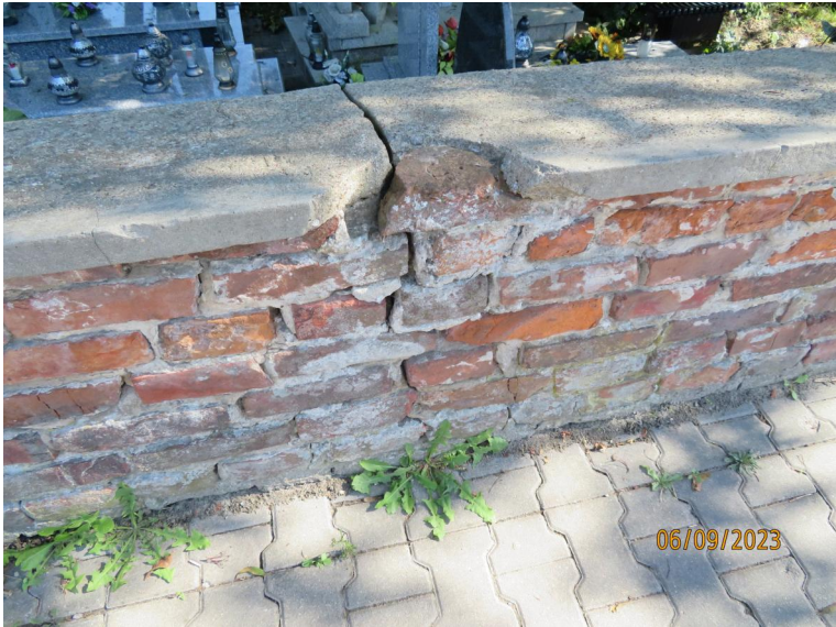
Przęsło z pęknięciem w murze i czapce betonowej - przeznaczone do napraw, zszycia, uzupełnień oraz konserwacji
